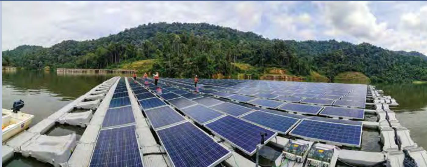
Fig. 1 - Floating PV System 270 kW, Rembau, Negeri Sembilan Darul Khusus (Photo: Sterling Fiesta Sdn Bhd).
